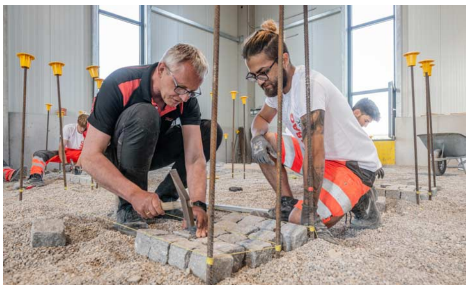
Der Strabag-Konzern nimmt heuer Lehrlinge primär in vier Hauptlehrberufen auf: Beton-, Hoch-, Tiefbauer und Pflasterer.
